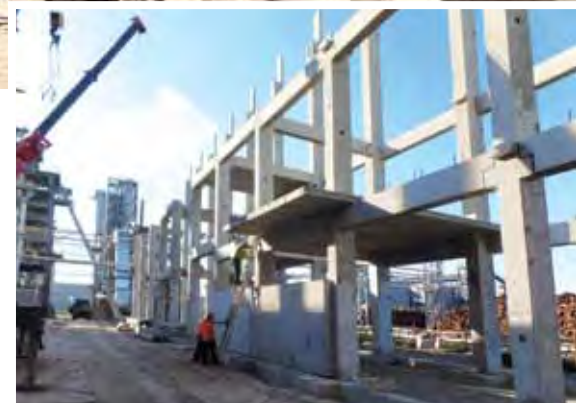
Монтажная бригада компании монтирует свыше 70% всех заказанных каркасов, в том числе в сейсмозонах
